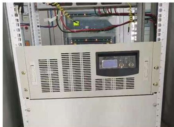
河南郑州市配电室
